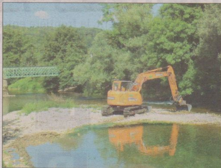
A Vecqueville, le lit de la Marne était encombré de matériaux ayant créé une différence de niveaux entre l'aval et l'amont de ce barrage naturel.
