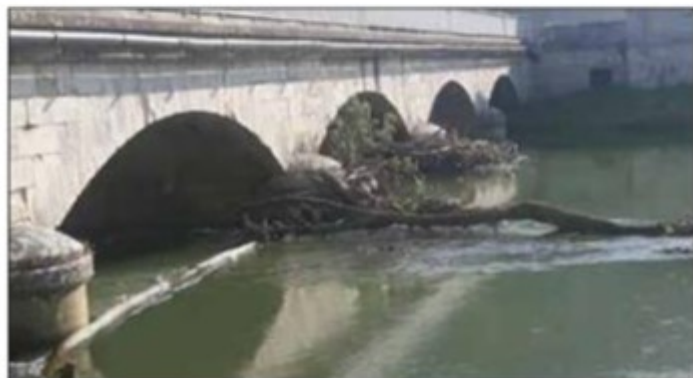
Divers ouvrages ont été encombrés d'arbres morts, comme ici à Vouécourt.
